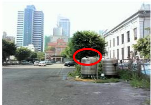
停車廠水塔無蓋
